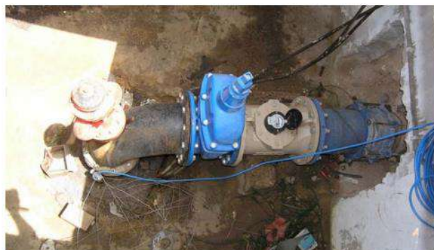
FIGURA 4. CAPTACIÓN SUBTERRÁNEA EN LA QUE EL CONTADOR ESTÁ UBICADO JUSTO AGUAS ABAJO DEL CODO DE SALIDA.
