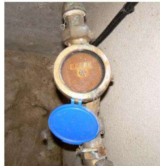
FIGURA 3. CONTADOR DE CHORRO ÚNICO OBSTRUÍDO POR LA ARENA.
