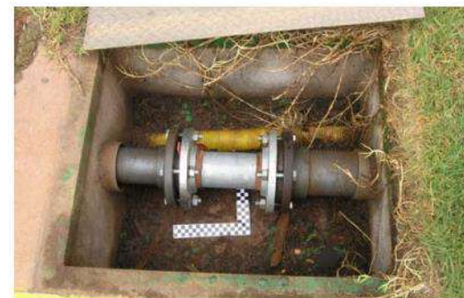
FIGURA 4. CONTADOR SITUADO AGUAS ARRIBA DE UN FILTRO.
